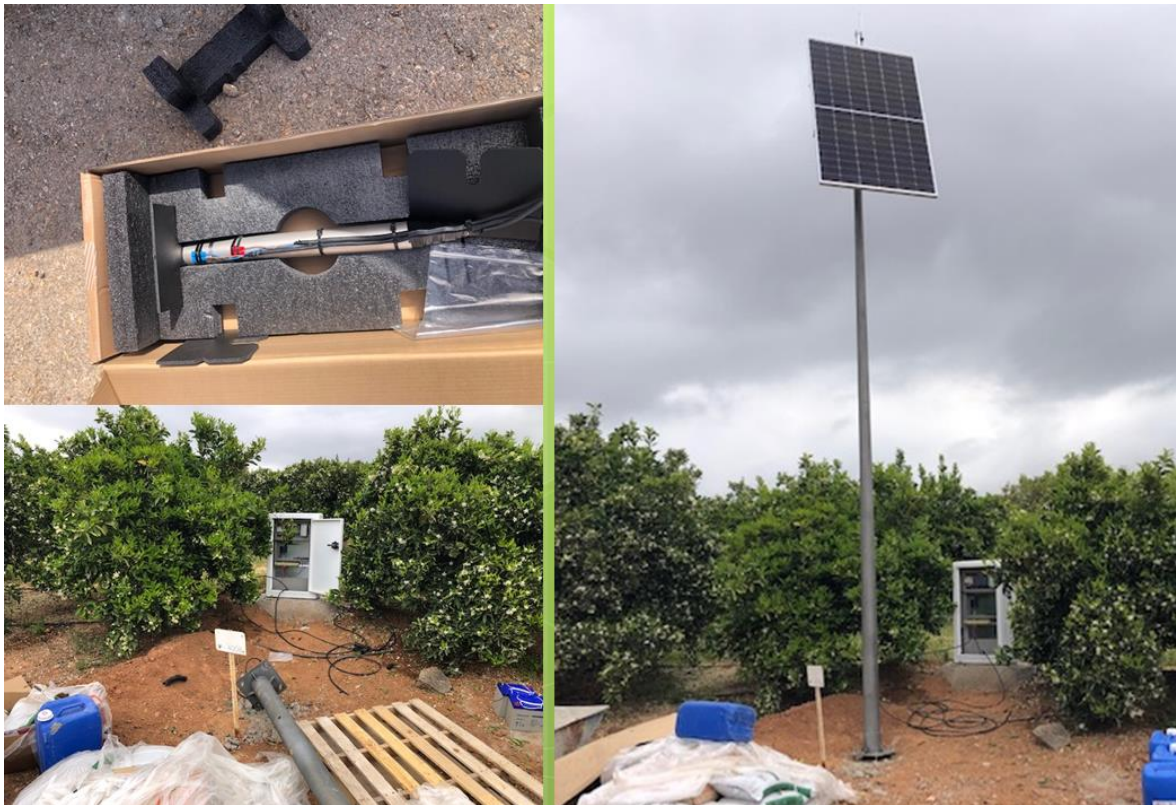
Figura nº 2. Instalación de espectrofotómetro en profundidad
