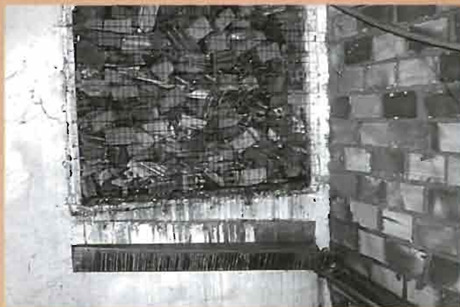
Figura 8: Sistema de refrigeración original. El agua enfriada a través del filtro de tejas se pone en
