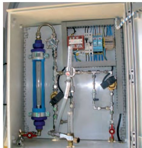
Cuadro de control Abelló Linde para la adición de gases
