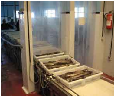
Instalaciones de línea de venta de pescado en el Puerto de Cudillero (Asturias)
