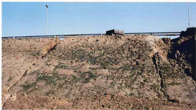
Fig. 17.-Erosión producida por la lluvia en un talud de camino.
