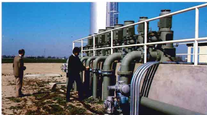
Fig. 15.—Estación de bombeo al aire libre.
