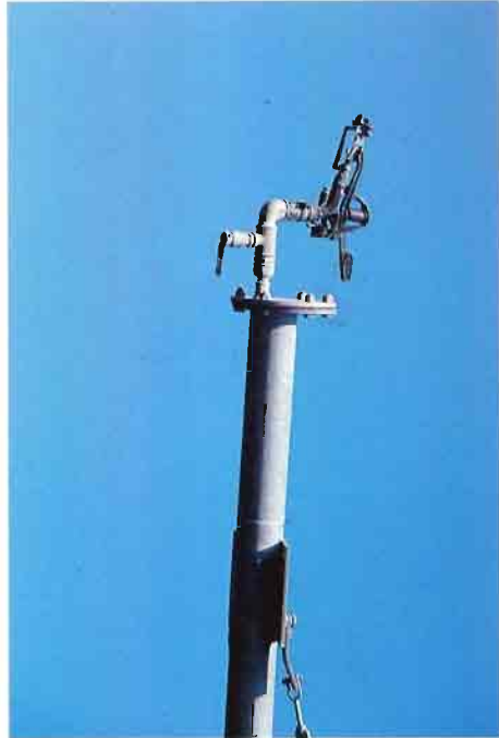
Fig. 9.-Detalle del aspersor final del pivot.
