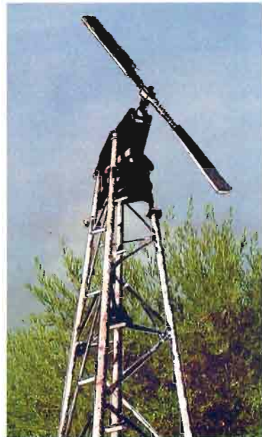
Fig. 2. Torre ventiladora. La altura del eje de las palas del ventilador ha de estar entre los 12 y 14 metros de altura. El diámetro de las palas, de 3 a 5 metros, girando a 600/800 revoluciones por minuto. El ventilador ha de girar sobre su eje vertical a razón de una vuelta cada 3 minutos, aproximadamente.
