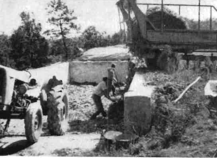
Fig. 5. - Haciendo el llenado lateral se evita la entrada de tierra en el silo.
