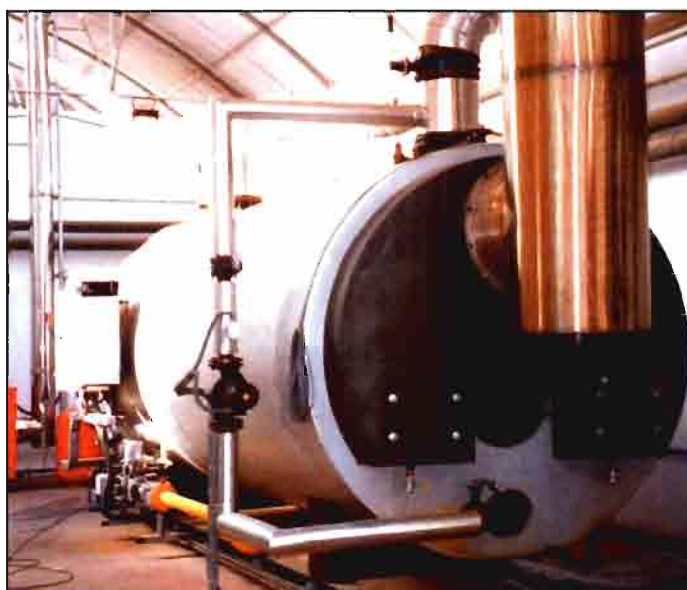
Figura 11. Caldera de calefacción por agua caliente.
