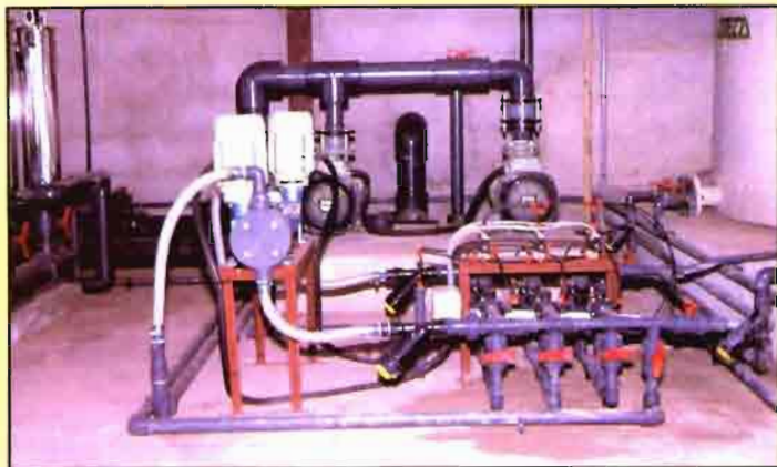
Filtros y automatismos en el cabezal de riego.
