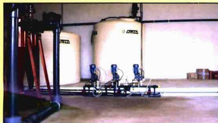
Depósitos fertilizantes con bombas dosificadoras de abonos para una correcta fertirrigación.
