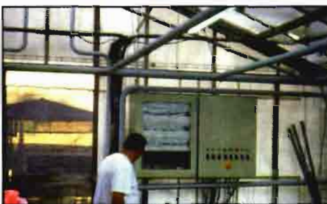
Cuadro eléctrico para el control de un invernadero.
