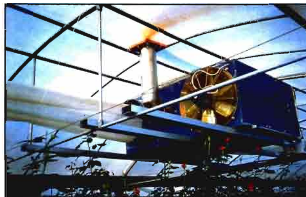
Generador de aire caliente y tuberías de distribución de plástico flexible (Valencia).
