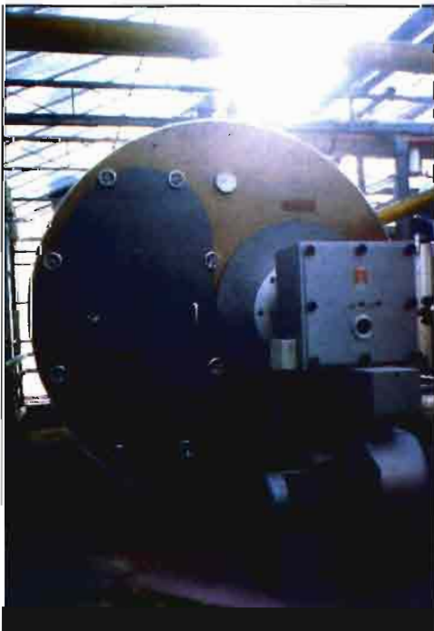
Caldera de calefacción a gas (Holanda).
