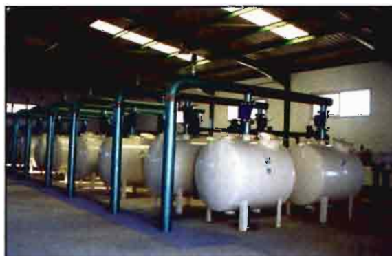
Estación de filtrado de la Comunidad de Regantes de Relámpago que abastece agua limpia para el riego de 1.500 hectáreas de olivar y con capacidad de limpieza de 800 m 3 /hora. En primer término filtros de arena, al fondo filtros de malla.
