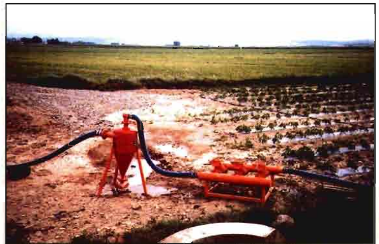
Cabezal de filtración para riego por goteo en tomate de industria.
