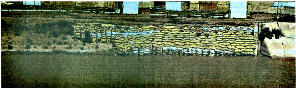
Fig. 9.—La acción excavadora de P. clarkii alrededor de una válvula de desagüe de fondo, provocó (1982), en el canal Principal de Mínima, una fuga de agua creando una brecha de varios metros, con el consiguiente arrastre de tierra.
