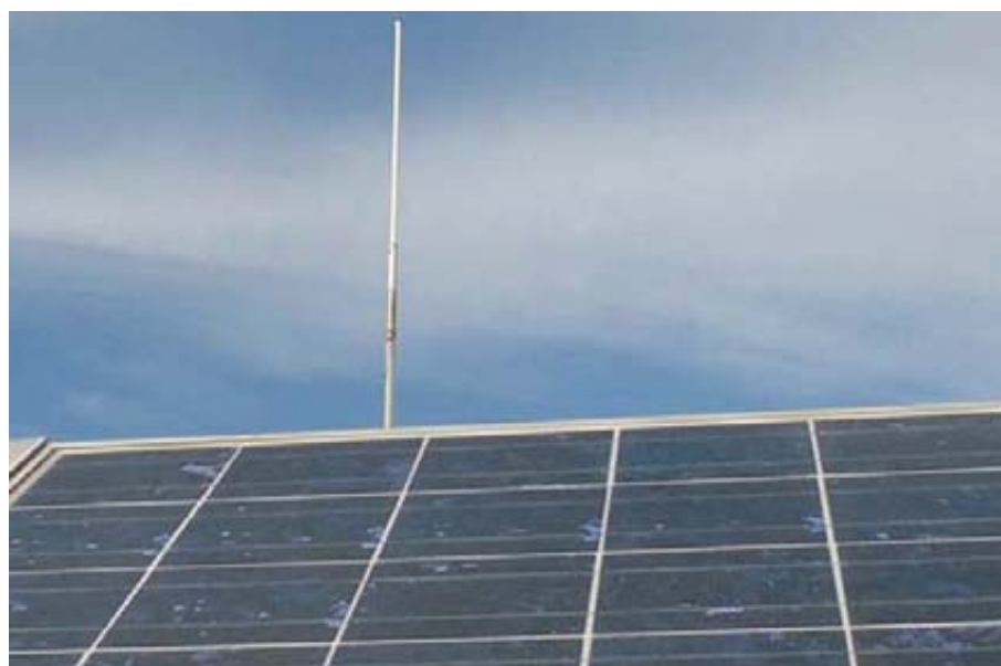
Foto 5. Al fondo antena wi-fi que conecta las cámaras de visión a internet con seguridad y placa solar que suministra la energía necesaria para mantener todo el equipo de control y seguimiento de la visión artificial.
