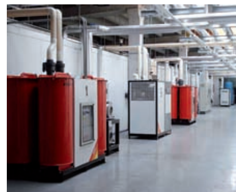
Equipos para el mantenimiento de las condiciones de CO_2 y O_2 requeridas en cámaras de conservación según los principios de las atmósferas dinámicas.
