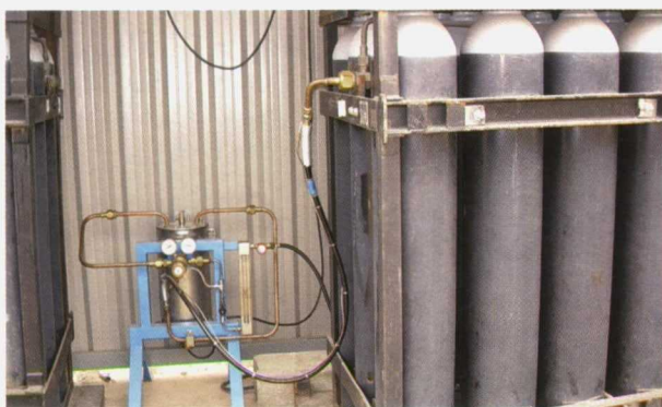
Sistema de distribución de CO 2 puro.
