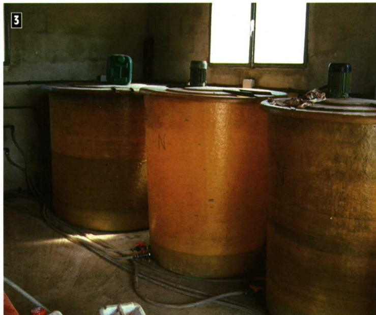
Depósitos de abono para fertirrigación.
