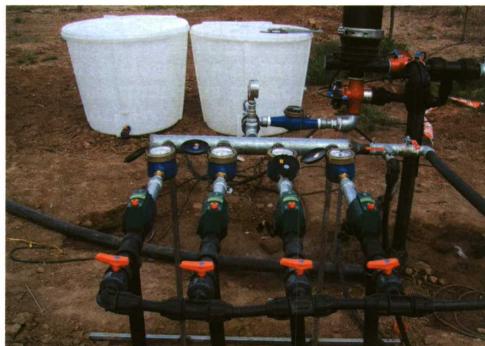
Cabezal de riego que permite aplicar el agua a las diferentes tesis que se comparan en este ensayo. Un programador de riego acciona las electroválvulas, lo que permite aplicar los turnos y el número de horas de riego de cada tratamiento. Los contadores certifican el volumen de agua aplicado. Además es posible aplicar los fertilizantes líquidos en función de un programa preestablecido.
