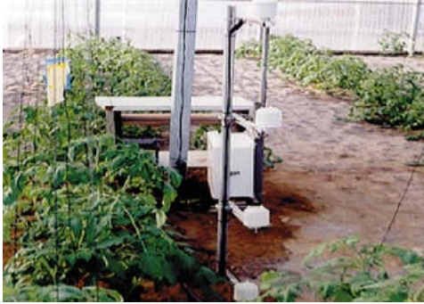
Foto 3. Estación control climático
