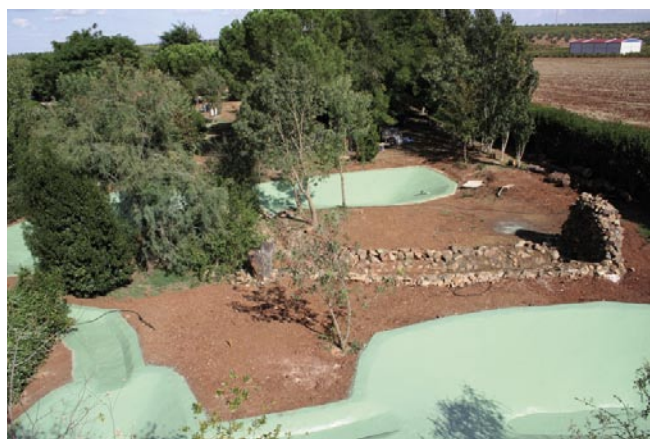
▲ Vista general de la primera fase de las instalaciones acuícolas del hospital de fauna salvaje
