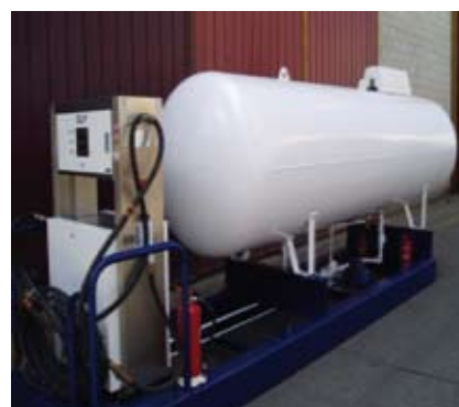
Unidad autónoma de suministro de propano como carburante.
