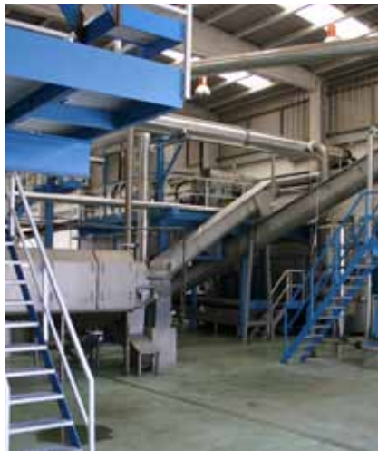
Instalaciones de la planta de tratamiento de subproductos.
