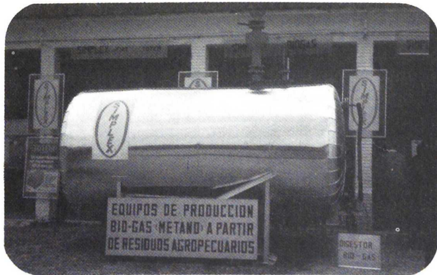
Digestor de una instalación de producción de biogás. En este depósito se producen las fermentaciones oportunas.
