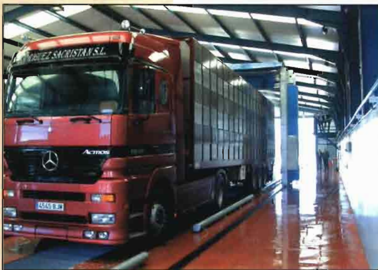
Son imprescindibles el vallado perimetral, los equipos de limpieza y desinfección de vehículos.
