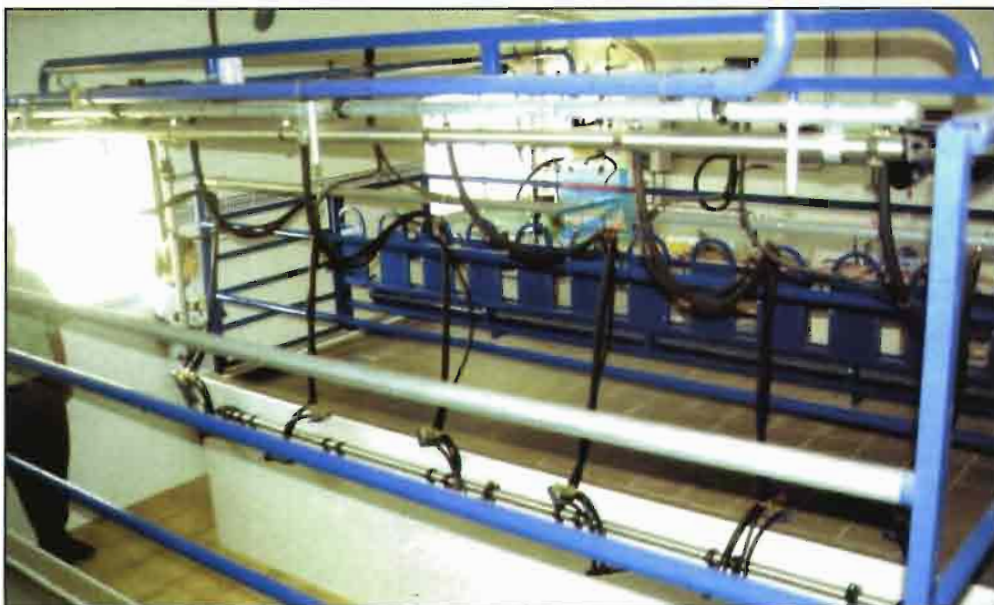
Instalación de ordeño en una explotación caprina.
