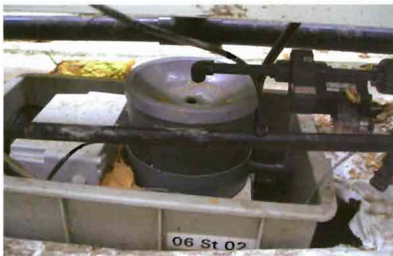
Detalle de la sujeción en el sistema de pesaje de los canales y recogida del agua de drenaje.
