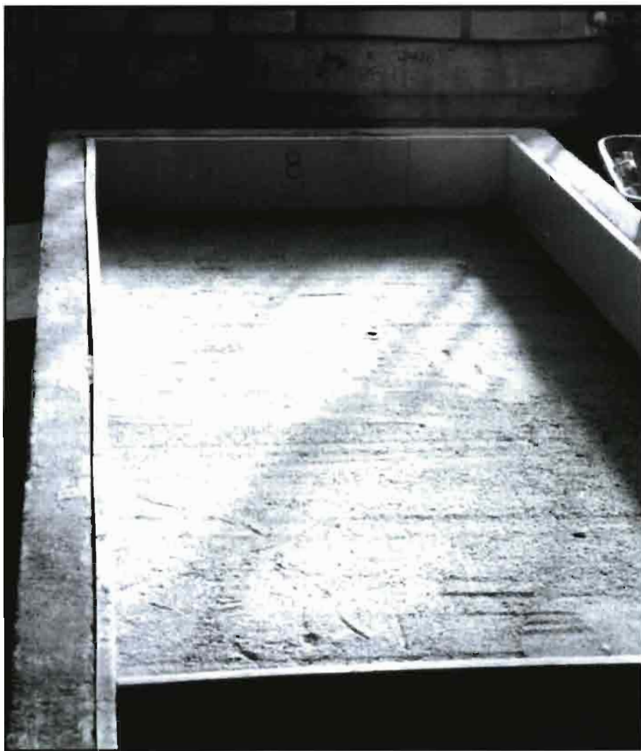
Disposición de una cama de arena en el fondo de la semimeseta, en una instalación de calefacción localizada del sustrato utilizando cable radiante eléctrico.
