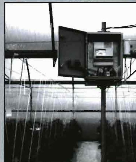
Vista general de cultivo de pepino, analizador-controlador de \text{CO}_2
