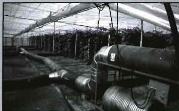
Generador de \text{CO}_2 de parafina y tubería de distribución
