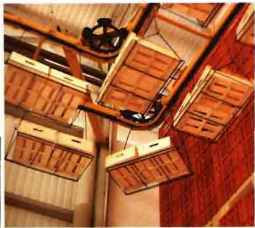
Arriba, transferencia de envases vacíos mediante transportador aéreo. Debajo, vista general de las líneas de salida de una calibradora electrónica.
