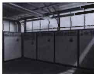
Automatizaciones (paneles de mandos).
