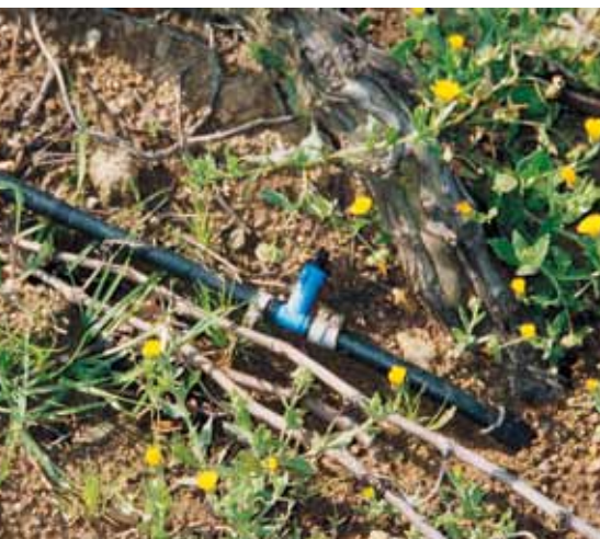
Foto 4. Válvula manual cierre de cada ensayo. Autor: Ester Pérez
