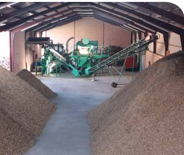
■ Nave del Centro de Producción y Logística de Biomasa en Lozoyuela (Madrid).
