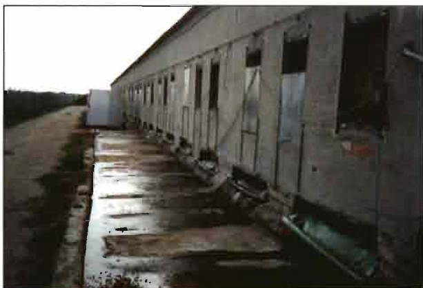
Salida de las deyecciones al exterior.
