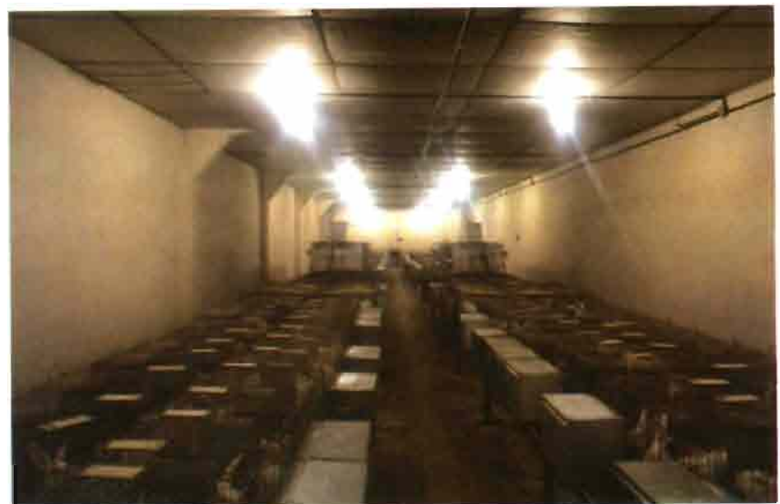
Instalacion de ambiente controlado, con refrigeración por humidificación y limpieza con agua a presión.
