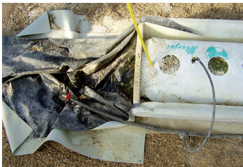
Foto 4. Detalle del sistema de conducción final de los drenajes de una línea de cultivo.
