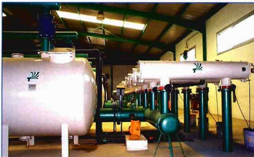
Cabezal de filtrado en la CR de Relámpago en Torreperogil (Jaén) en el que se observa (color amarillo) la bomba de inyección de fertilizantes líquidos en la red de riegos
