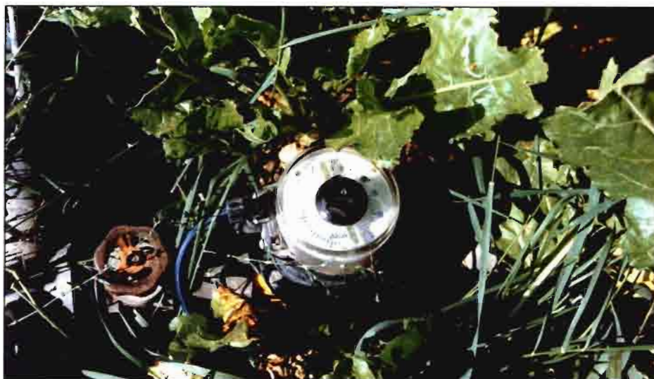
Válvula volumétrica dosificadora del riego en una parcela elemental de riego por aspersión
