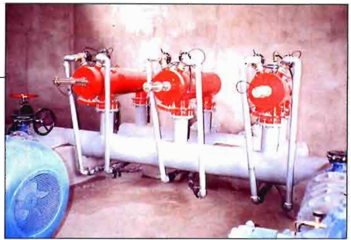
Batería de filtros automáticos de gran capacidad de filtrado en una gran comunidad de regantes
