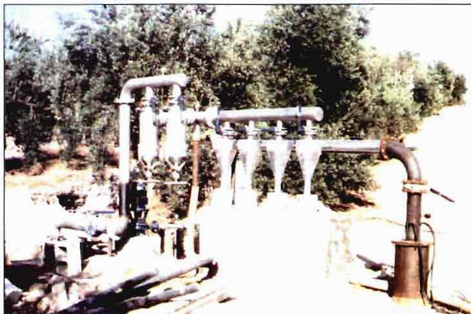
Cabezal de filtrado de una instalación de riego por goteo en la que se muestra una batería de 4 hidrociclones, que separa las partículas sólidas en suspensión en el agua de riego, y una batería de 2 filtros de malla. La limpieza del agua es garantía de un correcto funcionamiento de la instalación de riego por goteo.
