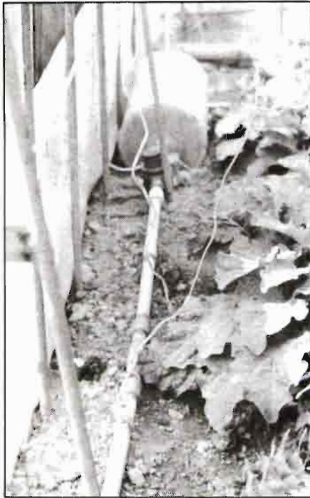
Barrilete y distribuidor en una instalación de energía geotérmica.
