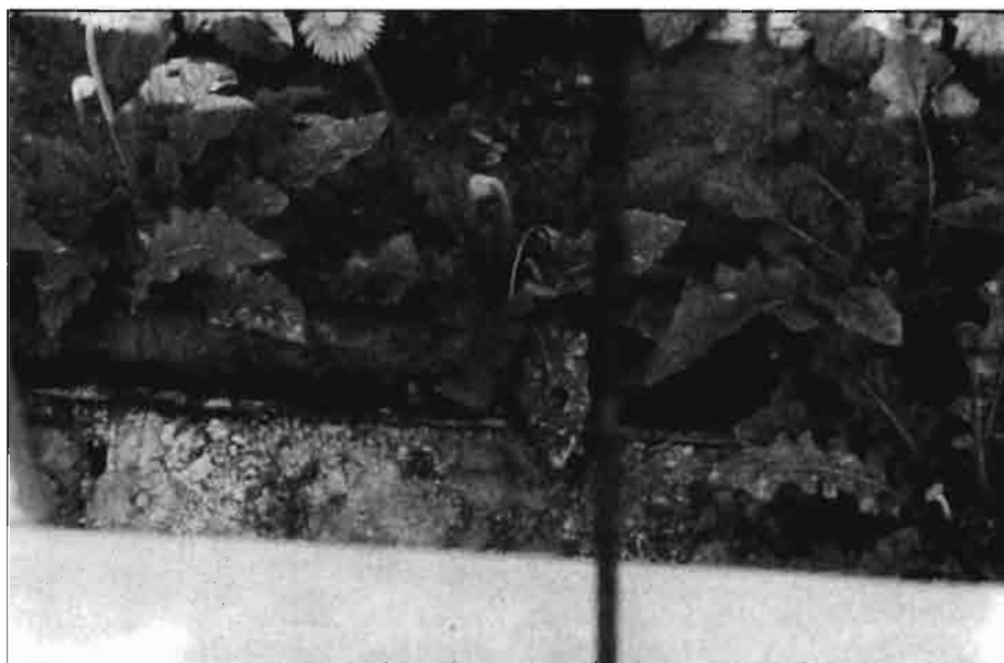
Manga radiante de polietileno portadora del fluido geotérmico.
