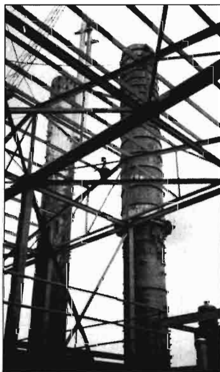
Detalle de las columnas de destilación. (Alt. 55 metros). Instalación Mississippi River Alcohol Company (Grupo Ferruzzi) para la producción de etanol procedente de cereales en LOUISIANA (U.S.A.) en construcción.
