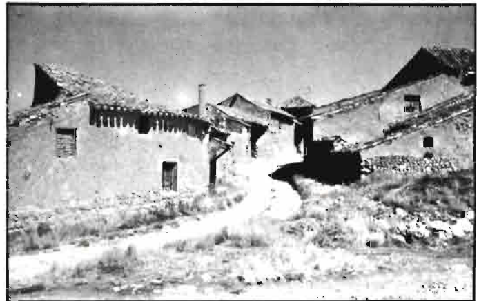
Pueblo castellano de adobe que necesita tratamiento especial para evitar su desaparición.
