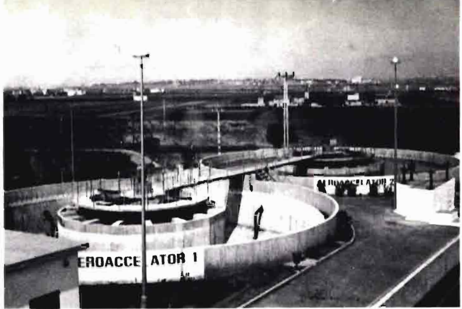
Vista general de la estación depuradora y zona regable del Pla de Sant Jordi.
