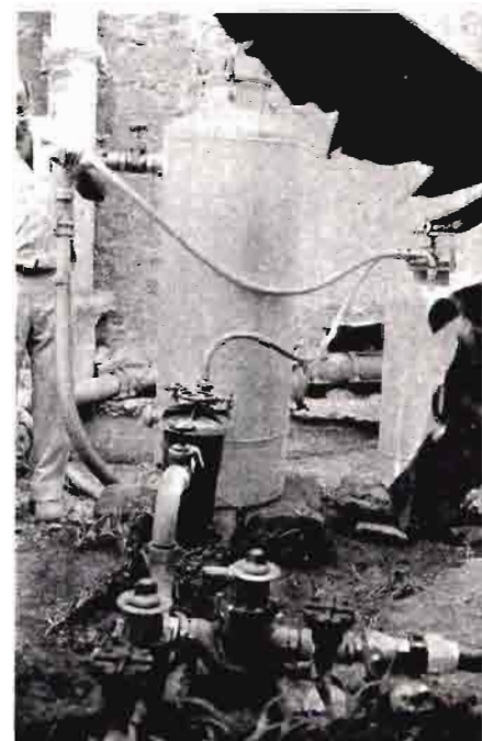
Cabezal con filtro de grava, filtro de malla, inyector de abonos y válvulas volumétricas
