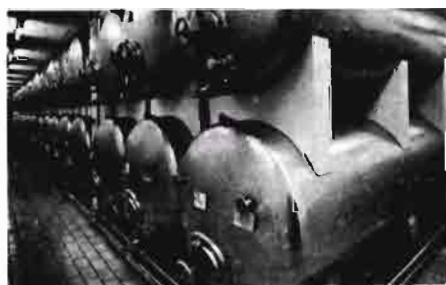
Bodega de conservación de vinos con 60 tanques de acero inoxidable de 6.000 litros de capacidad
