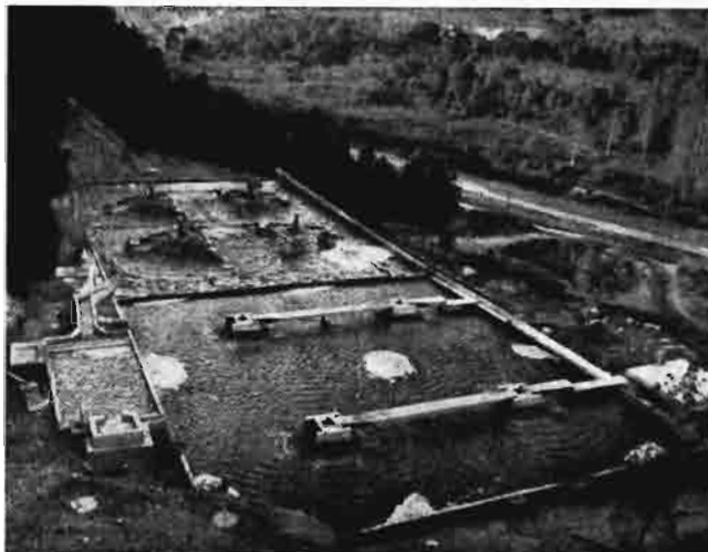
Fig. 5.—Otro ejemplo que cunde es el de depuración de aguas evacuadas por los mataderos. Esta, que trata 2.000 m 3 por día, está instalada en Abrera (Barcelona), para Industrias Cárnicas Purdom
