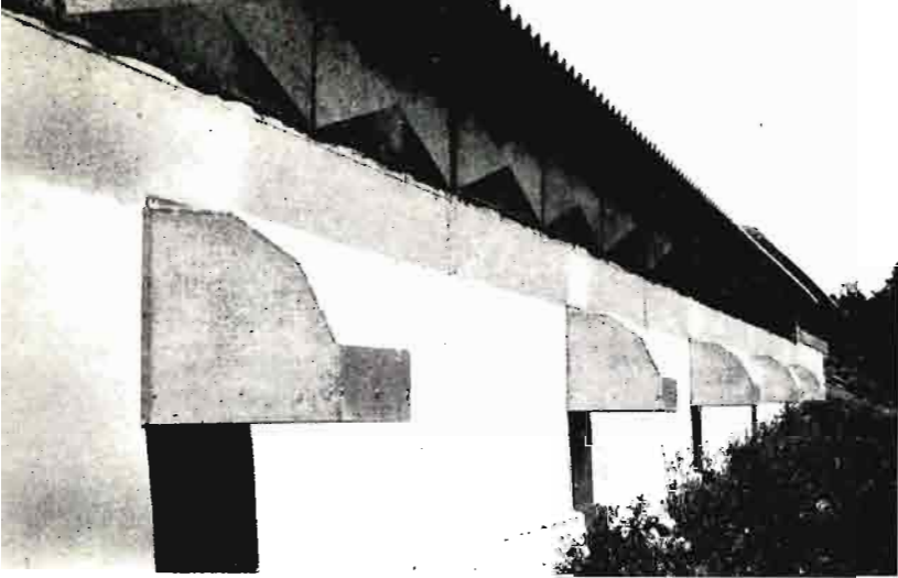
Exterior de un gallinero español de ambiente controlado. Perteneció a la Granja San Pere, S. L., en Villafranca del Panadés (Barcelona), y está dotada de ventilación forzada sistema «Cordillair». La abertura superior—cerrada—es para ventilación de emergencia en caso de fallo de corriente eléctrica
