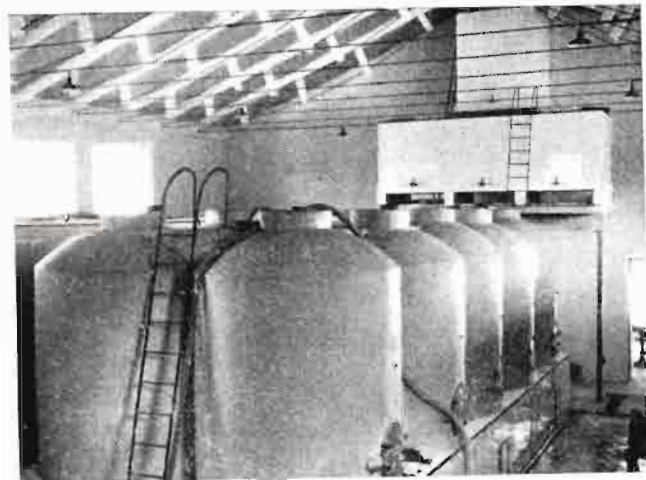
Vista de la bodega de la Escuela de Madrid. Grupo de conos de fermentación en virgen
