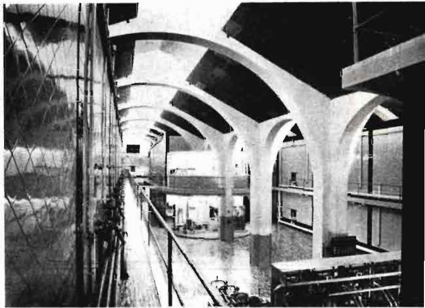
Modernas instalaciones de bodega para vinos de base de Segura Hermanos, en Torrelavid. En primer plano, a la derecha, vista posterior del cuadro de mando de la instalación centralizada de bombeo. En el fondo y al centro, la instalación frigorífica. A la derecha, las tinas isotérmicas. A la izquierda, las tinas de fermentación y conservación con las tuberías fijas
