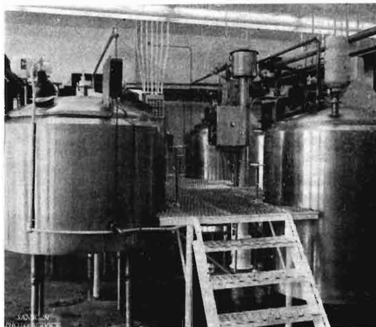
Tanques de mezclado y almacenamiento en fábrica de derivados de agrios.
